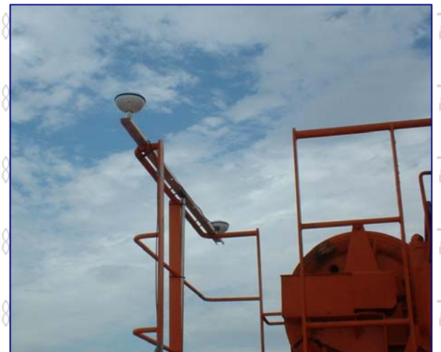
作業船上の GPS コンパスアンテナ設置例
